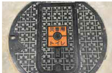
▲マンホールトイレ・災害時貯留槽 (平塚市消防署本署)
