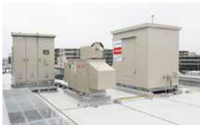
▲非常用発電設備 (平塚市消防署本署)
