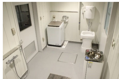
▲ 除染室 (白糠消防庁舎)
